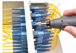
Abbildung 3-3: Prüfung eines Patchfeldes
